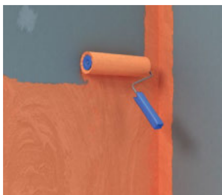
Illu. 6 : Appliquer au rouleau de la Sous-couche de protection à l'eau fermacell , en 2 couches, sur la totalité de la surface (épaisseur totale de l'enduit de couverture \geq 0,5 mm).
